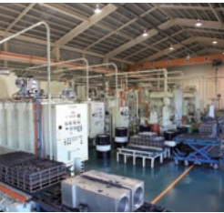
開発工場真空浸炭熱処理設備
