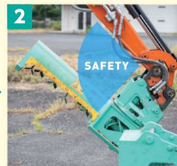
2 落下防止の角度センサーで安全
